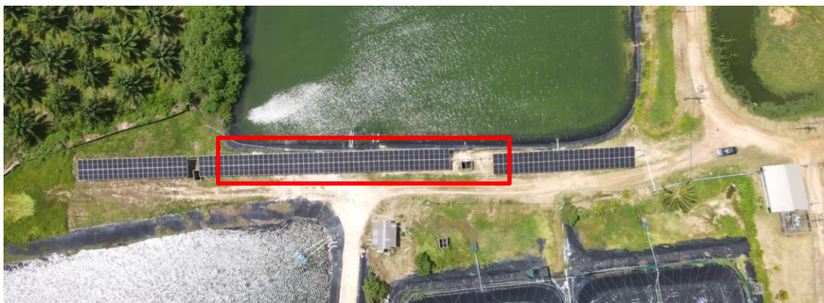
ภาพที่ 4-8: บริเวณที่มีการติดตั้งโครงสร้างผิดทำให้ต้องรื้อจุดติดตั้ง
