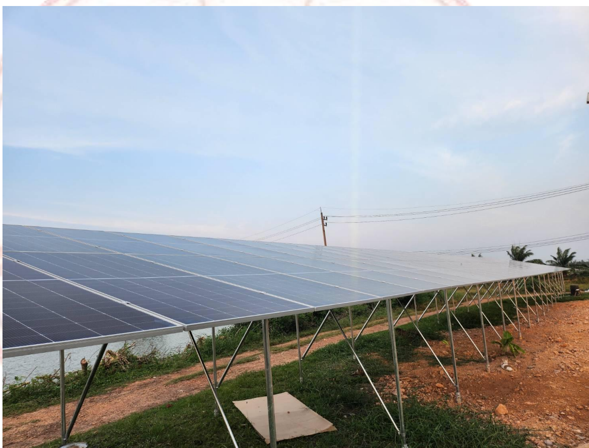
รูปภาพ 4-5: รูปภาพแสดงบริเวณที่มีการติดตั้งระบบผลิตไฟฟ้าพลังงานแสงอาทิตย์ ฟาร์ม D
