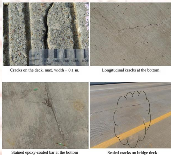
รูปที่ 1.1-1 ความเสียหายของพื้นสะพาน
