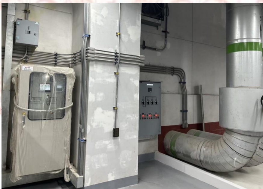
ภาพที่ 4-12 ความเสียหายภายในห้องสถานีถ่ายโอนพลังงาน อาคารที่ 2
