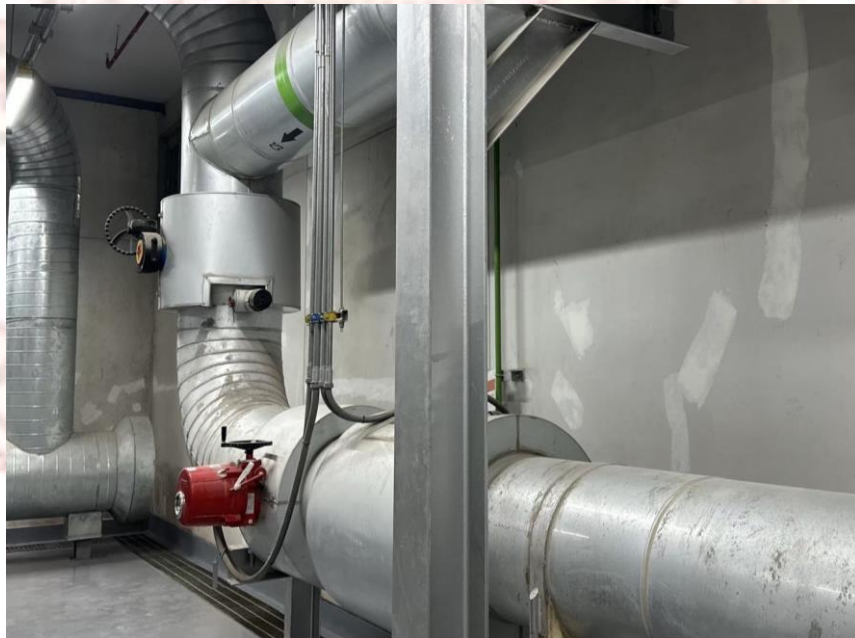
ภาพที่ 4-6 ความเสียหายภายในห้องสถานีถ่ายโอนพลังงาน อาคารที่ 1
