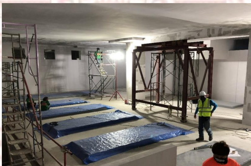
ภาพที่ 3-4 แท่นเครื่อง (Foundation) สำหรับห้องสถานีถ่ายโอนพลังงาน
