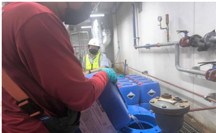
ภาพที่ 3-7 การเติมสารเคมีในระบบน้ำเย็น
